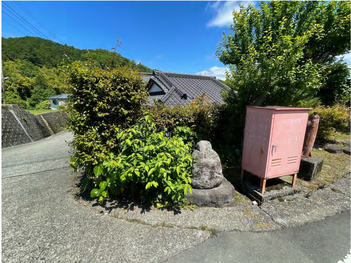
賽の神と同居する消火栓
